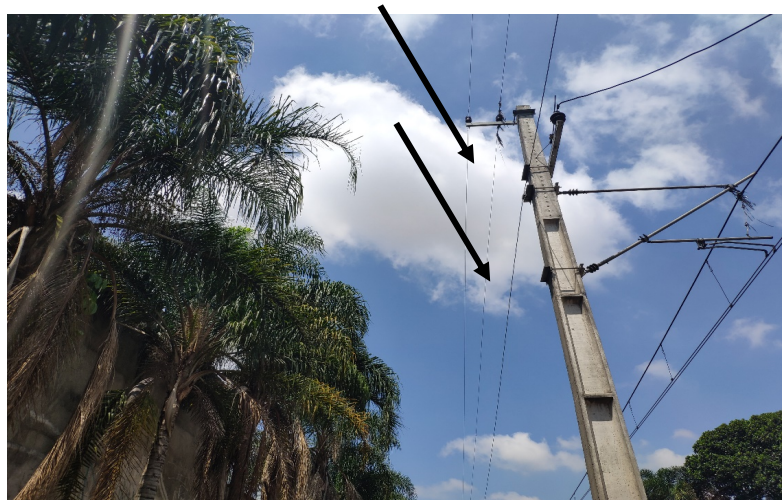
Figura 7. Imagem ilustrativa dos cabos de sinalização (CTC). Fonte: Foto tirada pelo autor (2020)
